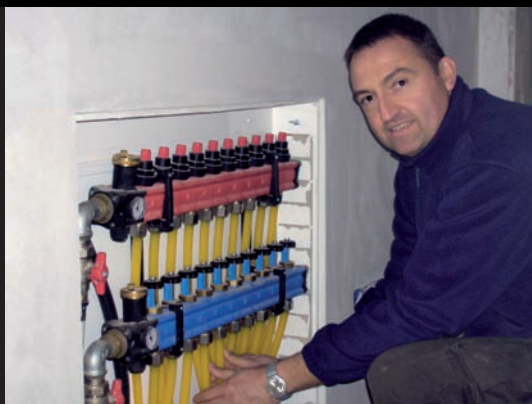
UN PARTICOLARE. Il collettore di distribuzione di in materiale termoplastico con inserti di ottone (Pantherm).
